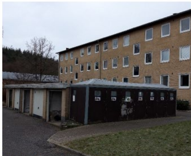
Affaldsskure placeret i forbindelse med garageanlæg. Affaldsskurene fremstår generelt slidte og under begyndende nedbrydning.
