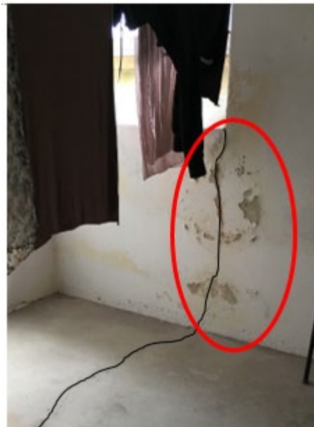
Revner i ydervæg
